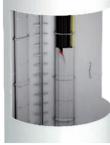
Bandázsolt kábelhágcsó egy szélturbinában.
