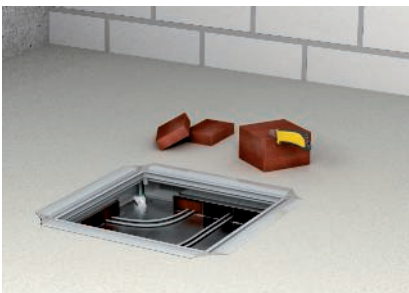
Keskeny csíkokat kell vágni a csatorna méretéhez igazítva.
