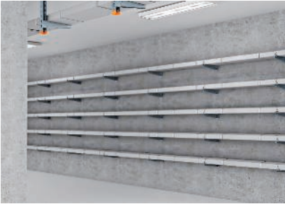
Erőművi kábelalagútban alkalmazott bandázsolás.
