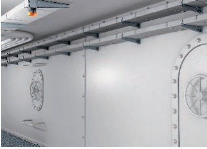
A kábelbandázs alkalmazása agresszív környezetben, pl. tengeren.
