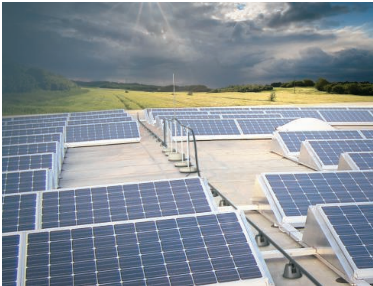
Lapostető napelemes rendszerrel és isCon® vezetékkel
