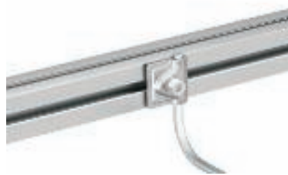
Villámvédelmi potenciálkiegyenlítés a napelemes tartószerkezeten
