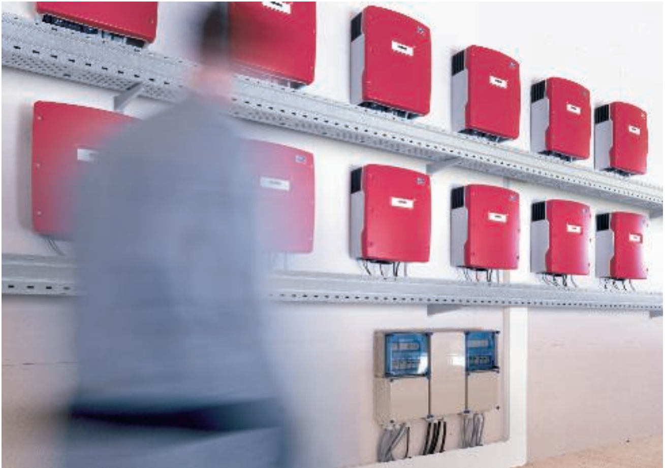
Vezetékezés kábeltartó-rendszerrel, műanyag fal csatornával és túlfeszültség-védelemmel
