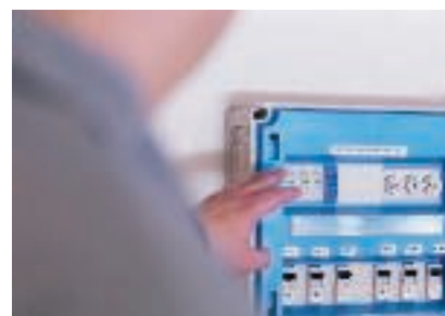
Túlfeszültség-védelem a napelemes rendszer AC-oldalán
