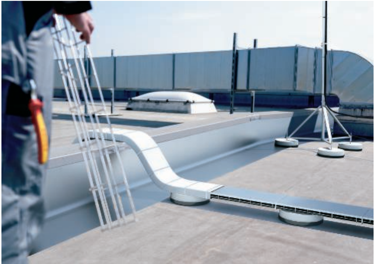
Lángterjedés elleni burkolattal ellátott kábelrendszer átvezetése a tetőtűz-terjedési gáton.
