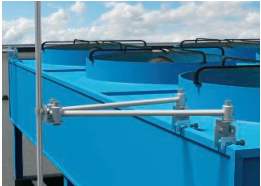
Elszigetelt villámvédelem GfK rögzítővel a hűtőegységhez
